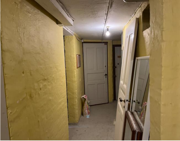
Foto 1: Kældervægge i Esthervej 16
