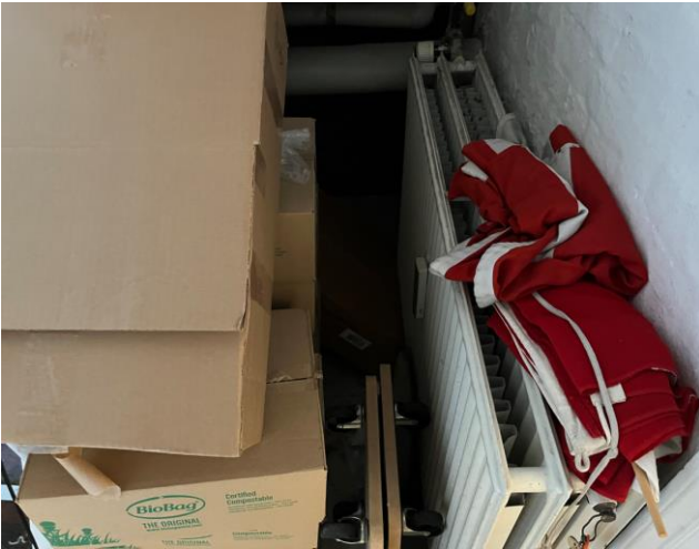
Foto 3: Opvarmning i kælder
