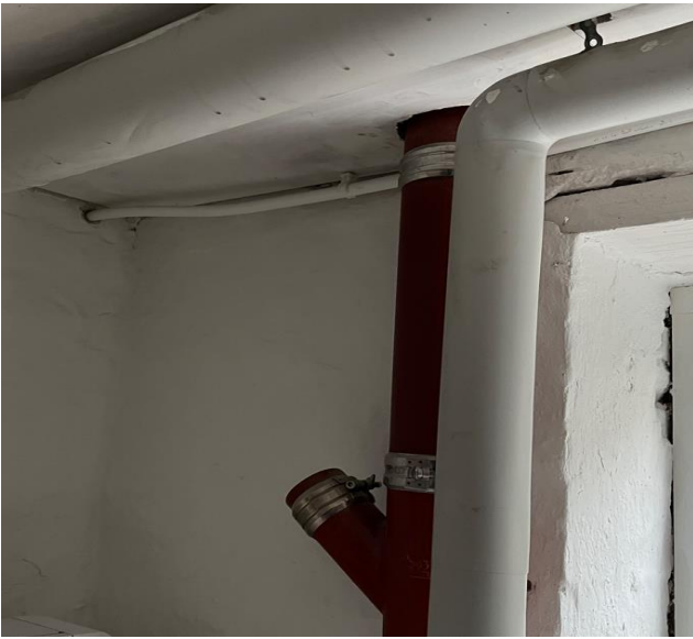
Foto 1: Faldstamme i kælder
