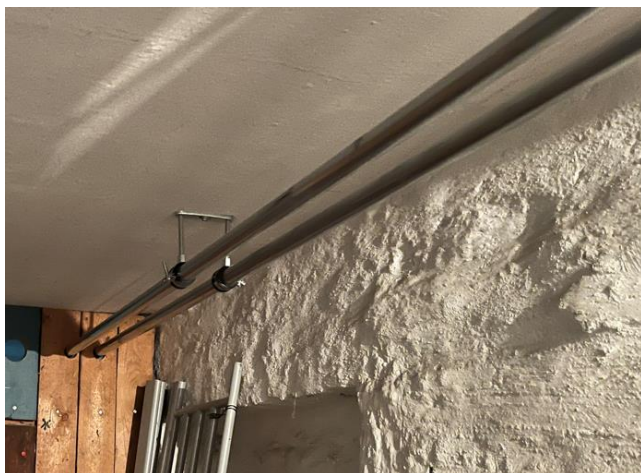
Foto 1: Fordelingsledninger i kælder
