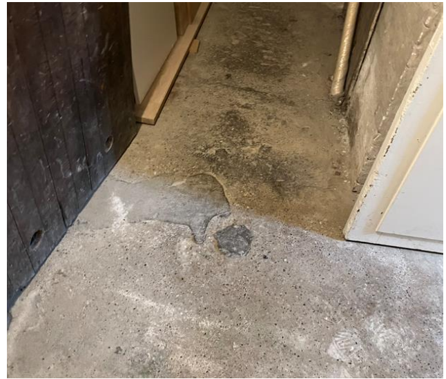
Foto 2: Kældergulv i Esthervej 16A
