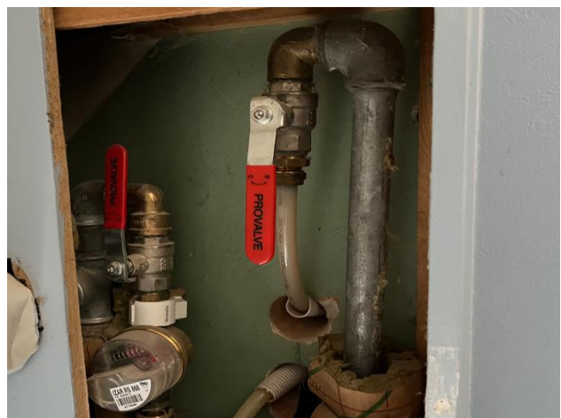
Foto 4: Stigstrengte brugsvand Esthervej 16
