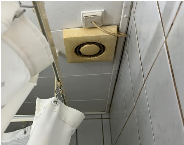
Foto 1: Mekanisk udsugning fra baderum
