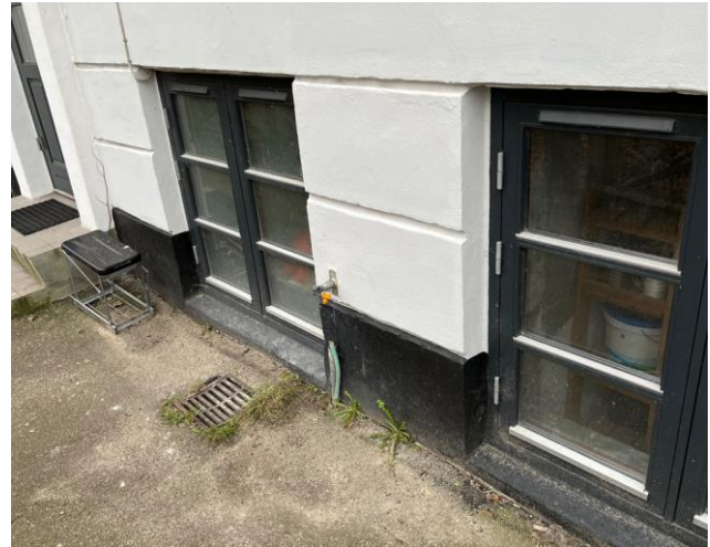
Foto 4: Ventilering af kælder
