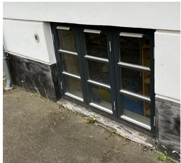
Foto 4: Ventilering af kælder
