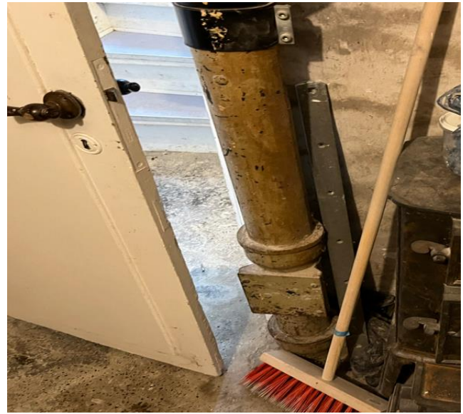
Foto 2: Faldstamme i kælder
